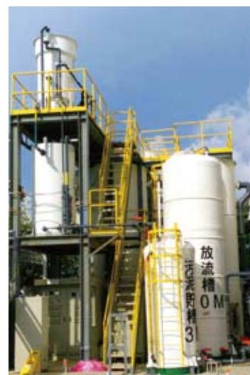
▲ 茂迪廠區廢水處理設備
